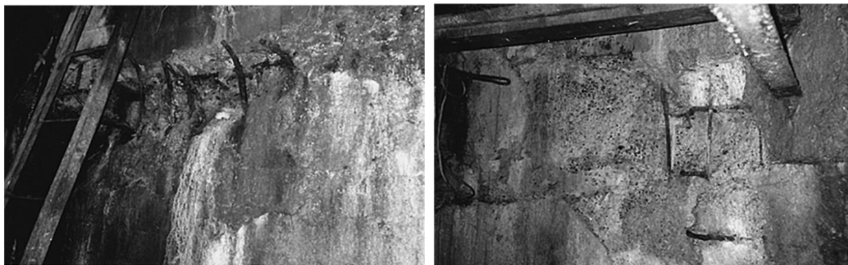
Рисунок 1.4 – Дефекты железобетонной крепи в виде каверн, сформировавшиеся вследствие компрессионного воздействия на дозаторную камеру с последующим выпучиванием арматурных элементов [38].
